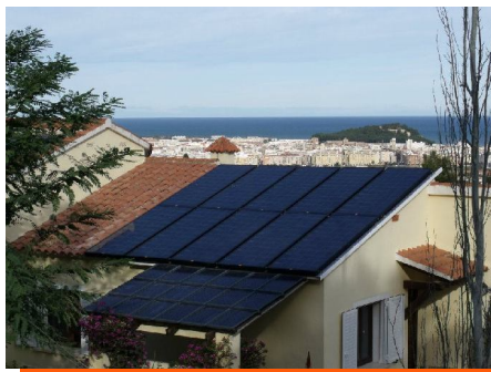
Instalaciones con colector híbrido SELA SOLAR M-240PVT
